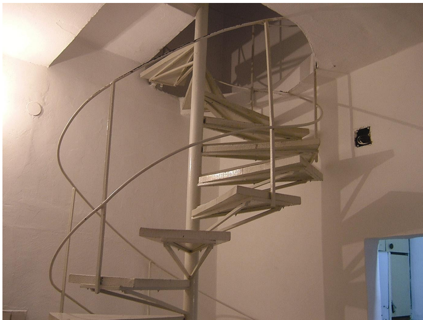
מדרגות לולייניות צפופות וגבוהות. בשל המרווחים הגדולים בין סורגי המעקה התוחם את המדרגות אין המעקה בטיחותי, והוא אף מסוכן לשימוש
