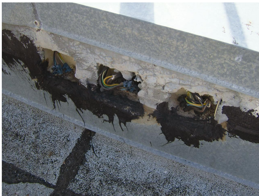
סדקים קשים בשילוב קילופי טיח בהיקף רחב, המעידים על תזוזות דיפרנציאליות של היסודות
