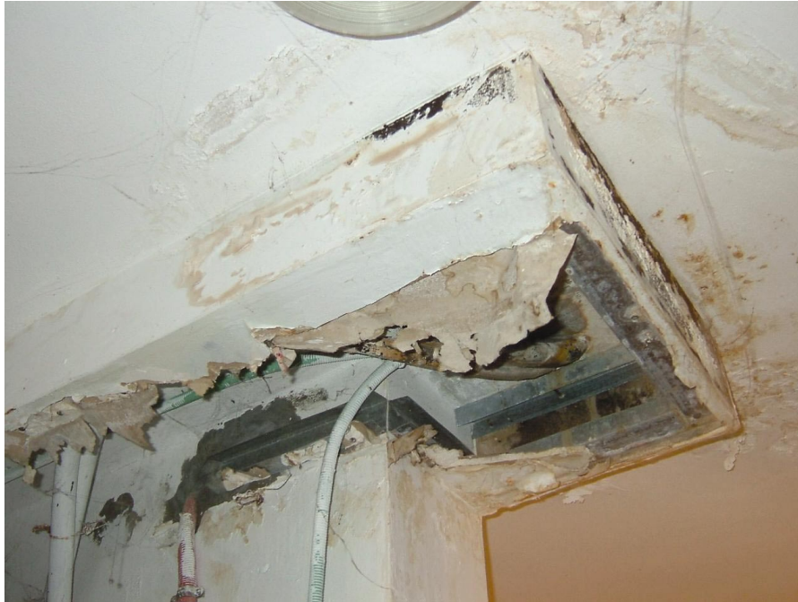
צנרת מים דולפת הגורמת נזקים קשים לחיפוי הגבס בתקרות ובקירות של חדר המדרגות
