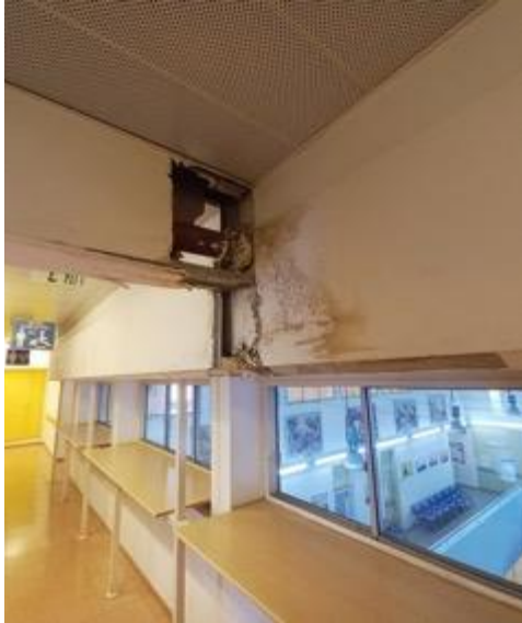
צינור מים שחיפיו שבור וחסר ובקרבתו ניכרו סימני רטיבות וקורוזיה במינהל קהילתי בגילה.
